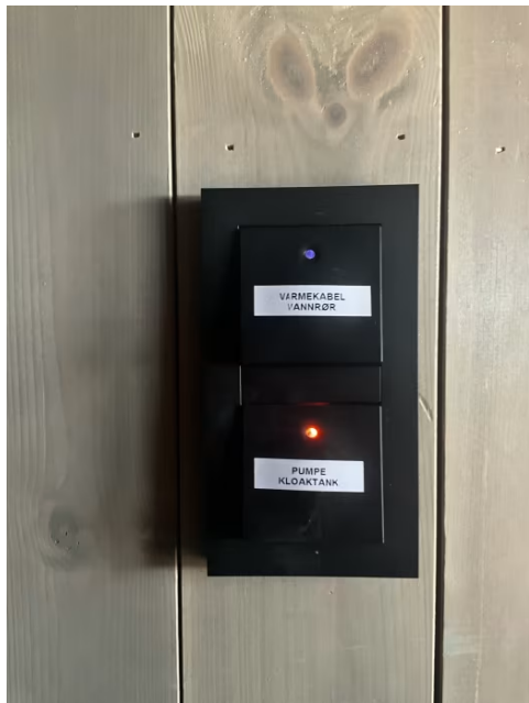
Viser bryter for varmekabler på vanninntak og bryter for kloaktank plassert i bod.
