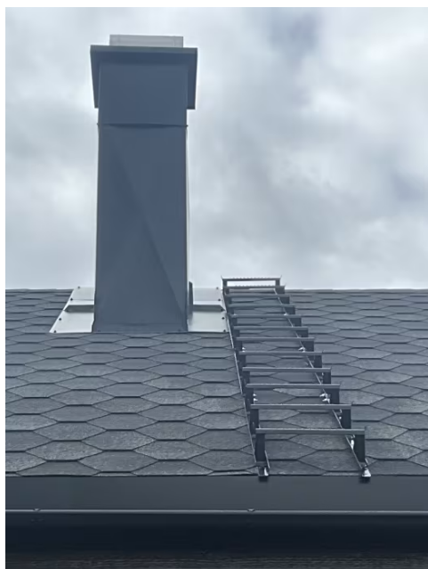
Viser pipebeslag og adkomst for feier.
