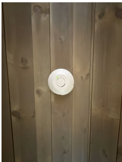
Viser brannvarsling i 2.etasje
