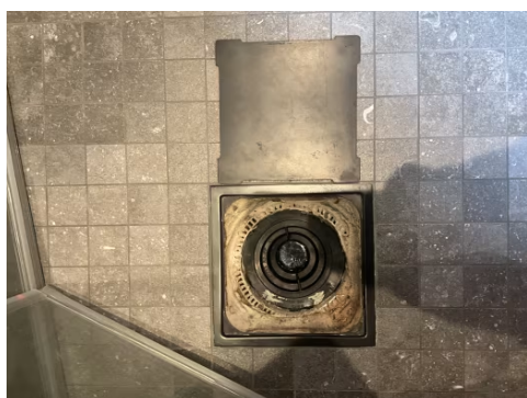
Viser sluk i dusjsonen.
