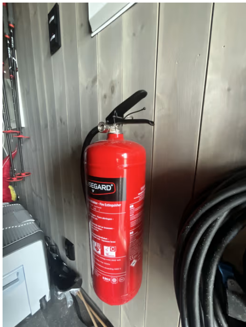
Viser brannslukningsapparat i bod.
