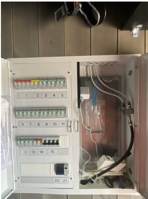
Viser innfelt sirkingskap med ekom del.
