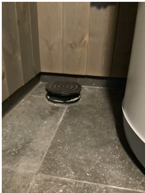
Viser durgoventil i utvendig bod.
