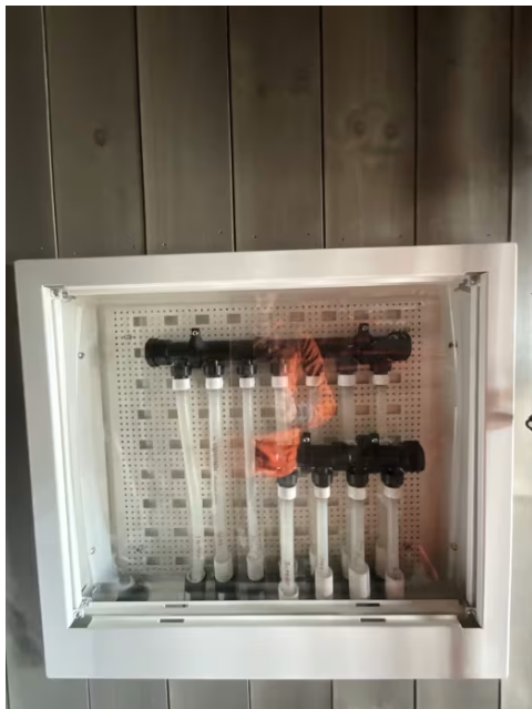
Vannrør med rør i rør system fra fordelerskap plassert i utvendig bod og frem til sanitærinstallasjoner på badetrom og kjøkken.
