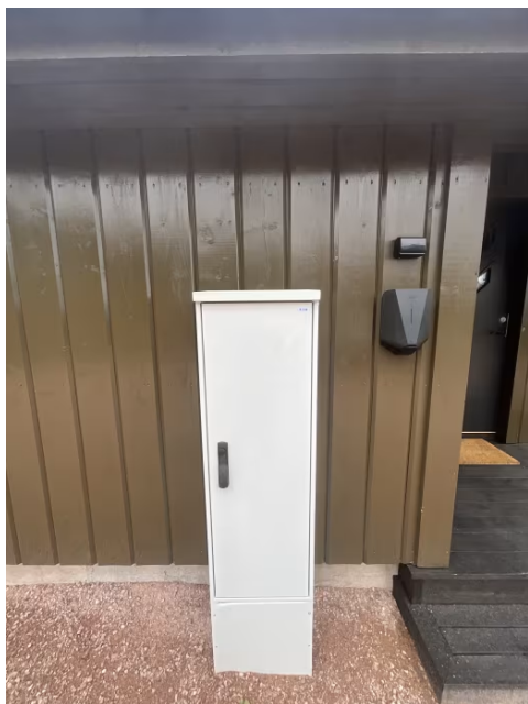
Viser inntakskap, easee elbillader og utestikk.
