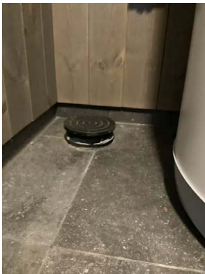
Viser durgventil i utvendig bod.
