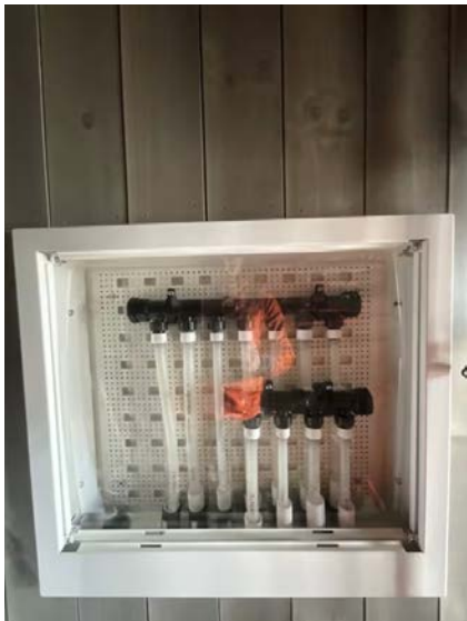
Vannrør med rør i rør system fra fordelerskap plassert i utvendig bod og frem til sanitærinstallasjoner på badetrom og kjøkken.
