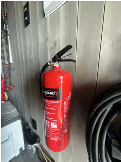
Viser brannslukningsapparat i bod.
