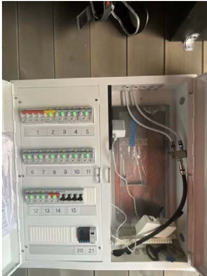
Viser innfelt sikringskap med ekom del.
