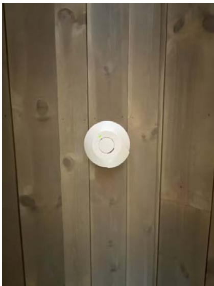
Viser brannvarsling i 2.etasje
