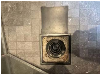
Viser sluk i dusjsonen.
