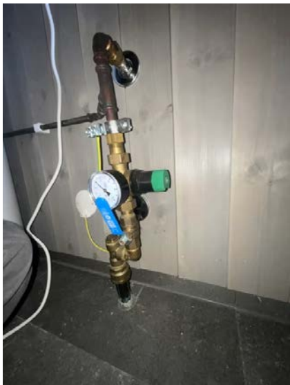
Viser vanninntak, trykkmåler og hovedstoppekran plassert i bod.
