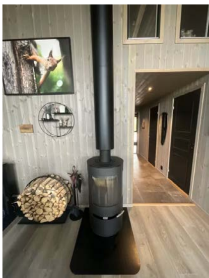
Viser ildsted montert i stue.
