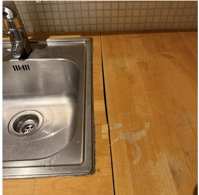
Slitasje og utett skjøt
