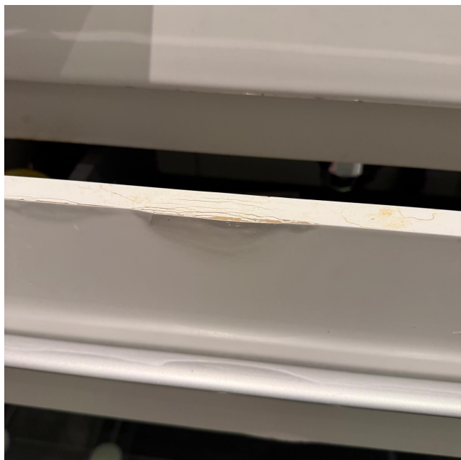
Skade på skuffer
