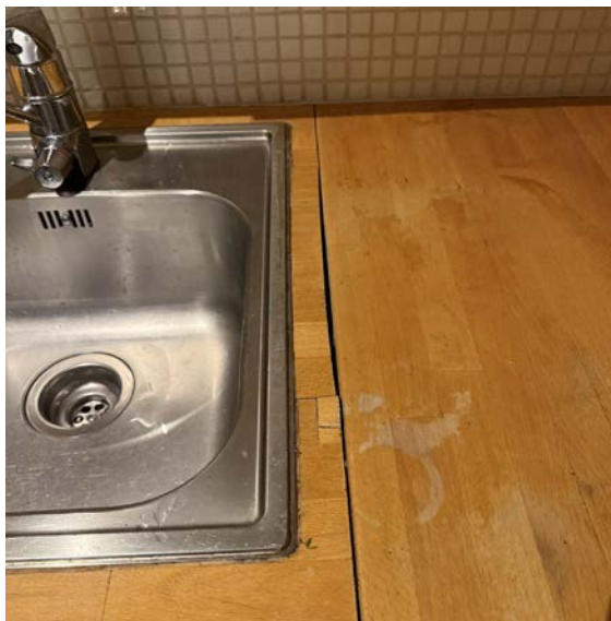
Slitasje og utett skjøt
