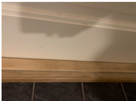
Mangler luftespalte ved døren
