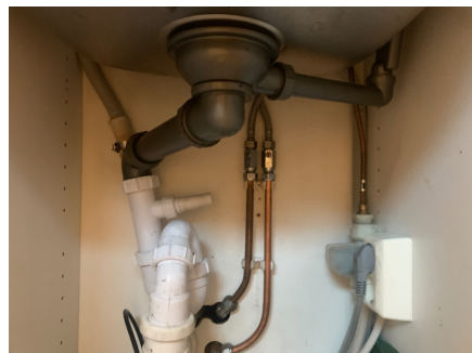
Røropplegget i kjøkkenet
