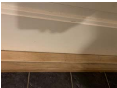
Mangler luftespalte ved døren
