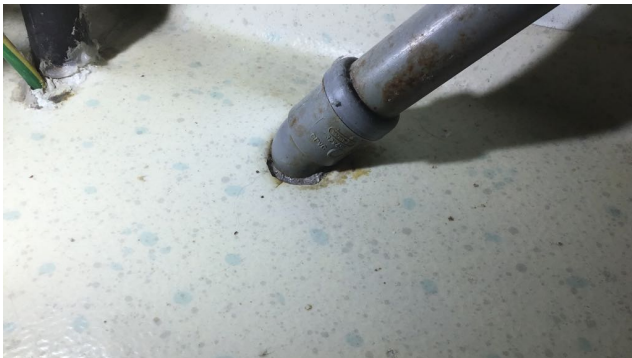
Utettheter rundt rør
