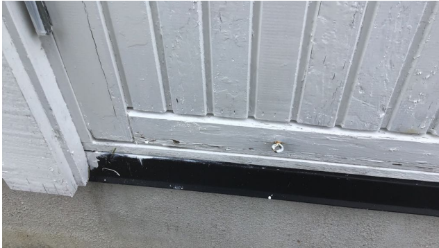
Balkongdør i 1 etg
