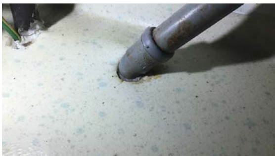
Utettheter rundt rør
