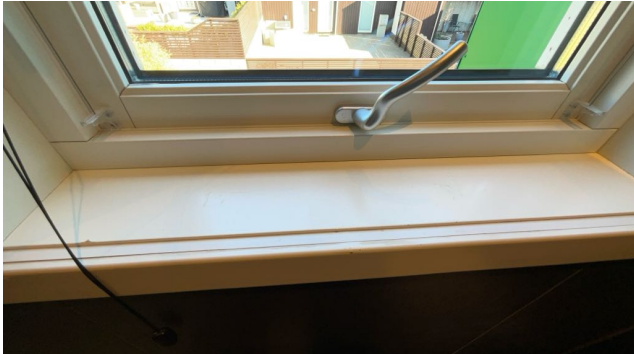
Mindre skader etter vannsøl i nedre vindusforing.
