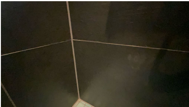
Saltutslag i flisefuger i dusj
