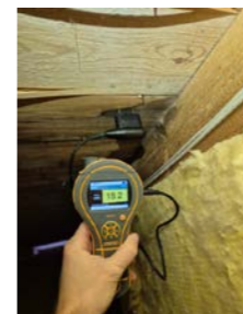
Målt noe høye fuktverdier ved pipe.
