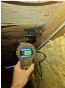
Målt noe høye fuktverdier ved pipe.
