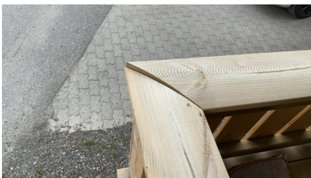
Vridd toppbord, med dårlig innfesting.
