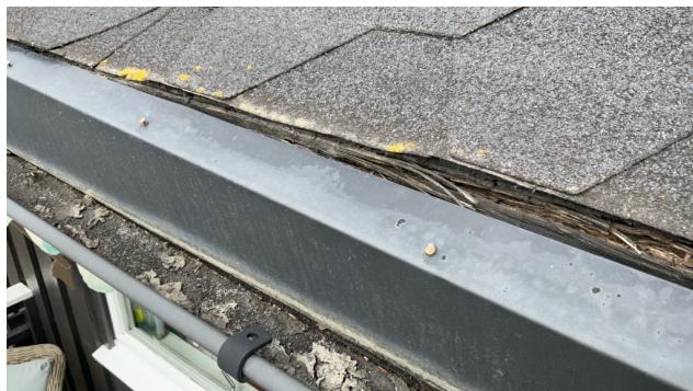
Råteskader i undertak, forkantbord og løst forkantblekk.
