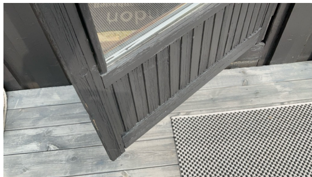
Utvendig værslitt panel.
