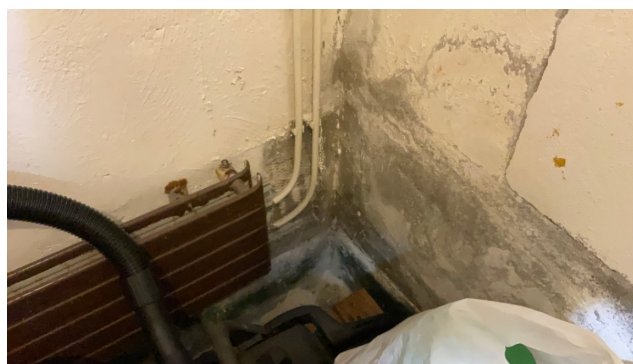
Fuktmerker og saltutslag.
