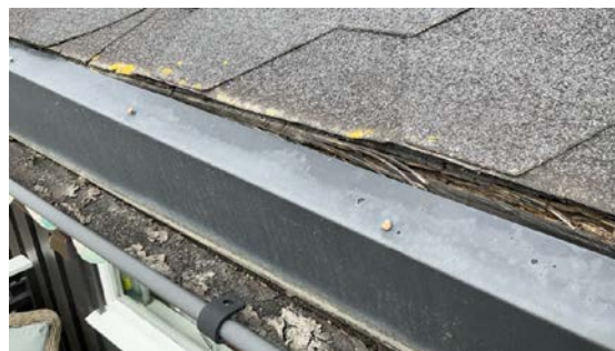
Råteskader i undertak, forkantbord og løst forkantblekk.
