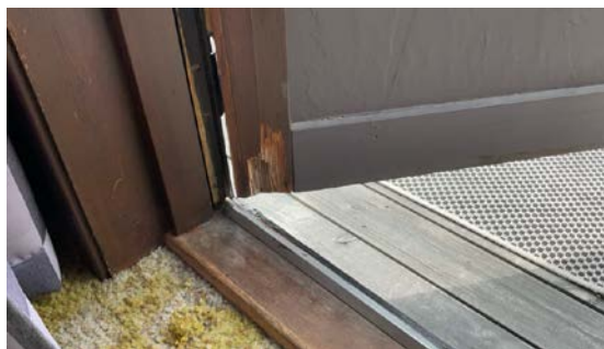
Skade i dørblad.
