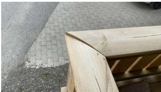
Vridd toppbord, med dårlig innfesting.
