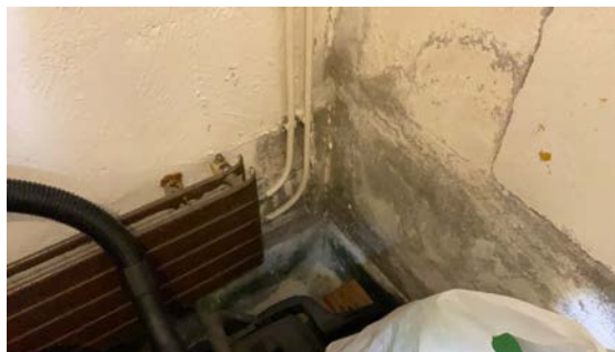
Fuktmerker og saltutslag.
