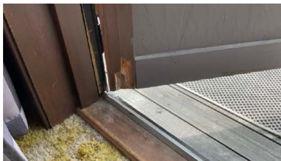
Skade i dørblad.
