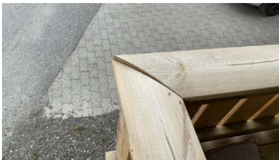
Vridd toppbord, med dårlig innfesting.
