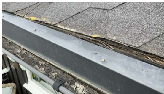
Råteskader i undertak, forkantbord og løst forkantblekk.
