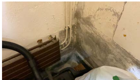
Fuktmerker og saltutslag.
