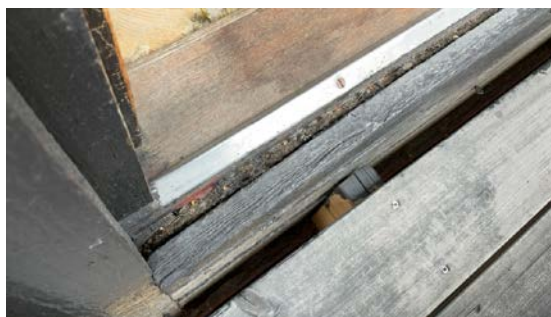
Utett mellom utvendig tetting og karm.
