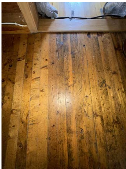
Viser slitasje ved gulvflater.
