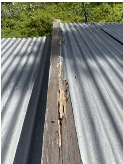
Isbord hovedsaklig uten metallbeslag. Det registreres råteskader.
