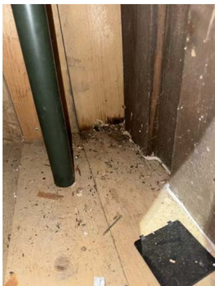
Det registreres muselort og hull i overgang gulv/vegg i bod antatt etter mus.
