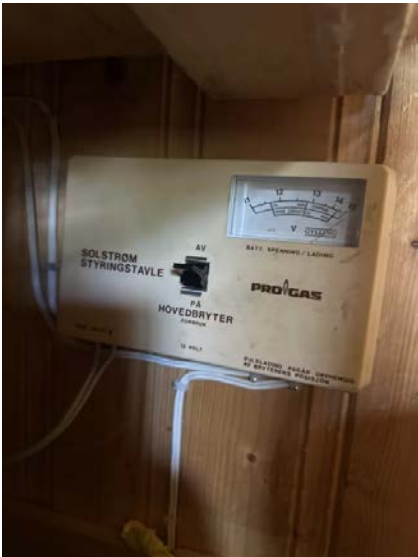
Viser styringstavle for solcelleanlegg plassert på kjøkken.
