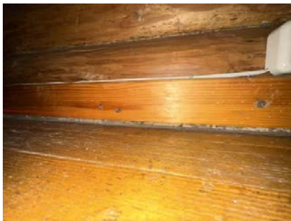
Det registreres store sprekker mellom gulv og list.
