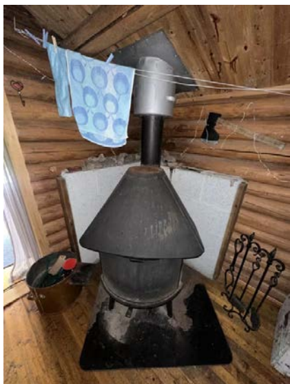
Viser ildsted i stue.
