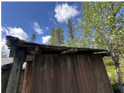
Byggverket med lokale råteskader og manglende vedlikehold.
