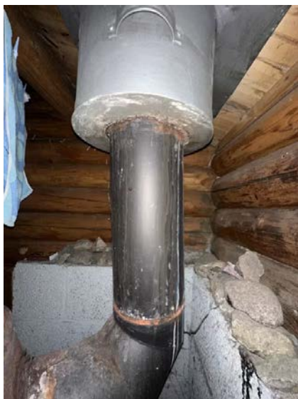
Det registreres rustdannelser på metallpipe.
