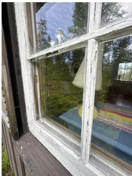
Kittfals (utvendig tetting mellom vindusramme og glass) er uttørket og stedvis løsnet.
