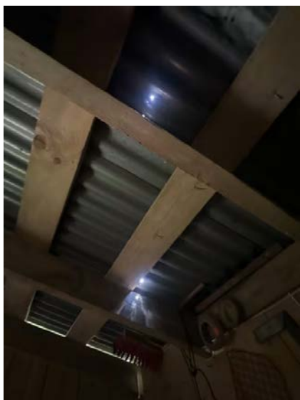
Det registreres mindre hull i taktekingen i bod.
