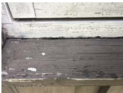
Nedre vannbrett med malt trevirke, noe varierende tilpassing.
