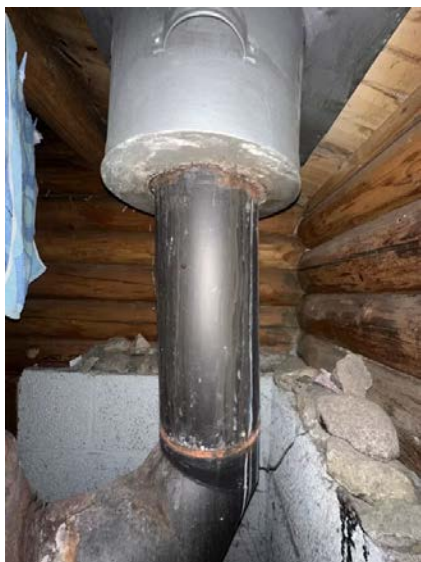
Det registreres rustdannelser på metallpipe.
