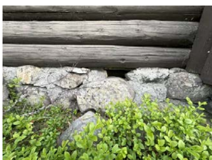
Hytte fundamentert på naturstein. Enkelte etablerte luftehull i ringmurer, utførelse uten dyresikringer.
