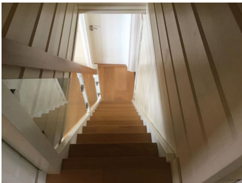
Mangler håndlist langs vegg i trappeløp
