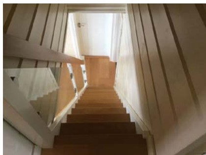
Mangler håndlist langs vegg i trappeløp
