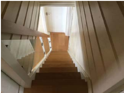
Mangler håndlist langs vegg i trappeløp
