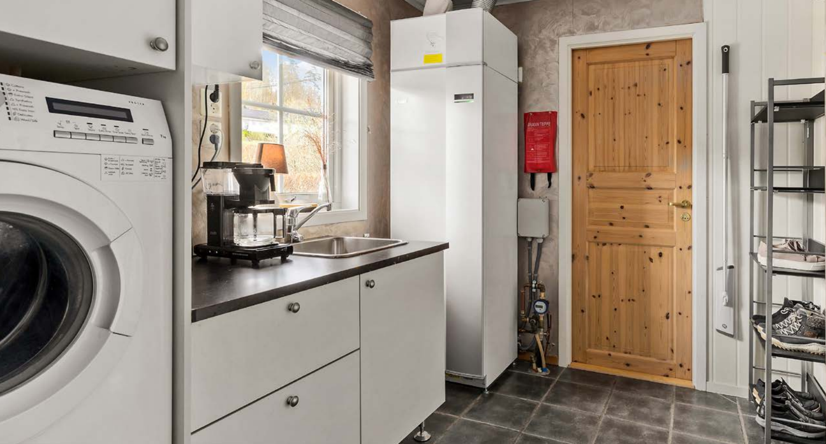
Vaskerom med flislagt gulv med vannbåren gulvvarme. Rommet har praktisk innredning, opplegg for vaskemaskin og en Nibe avtrekksvarmepumpe fra 2021 med 178 liters varmtvannsbereider.
