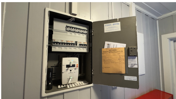
Kontroll av el-skap og kursfortegnelse.
