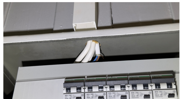
Kabelinnføringer i sikringsskap er ikke tilfredsstillende tettet.
