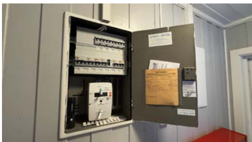
Kontroll av el-skap og kursfortegnelse.
