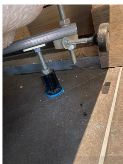
Overgang gulv/vegg, ser ikke ut til å være tilfredsstillende smurt med membran.
