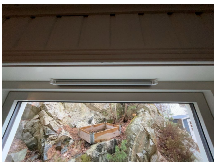
Eksempel på montert ventil i vindu.
