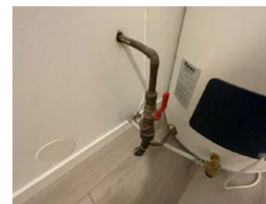
Stoppekran til vann.
