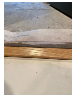
Bilde fra selger som viser membran opp mot dørteskel.
