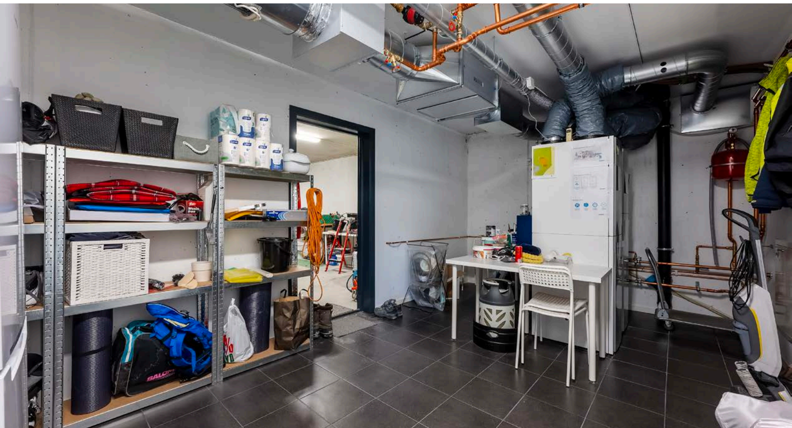
Teknisk rom med god plass (sokkeletasje)
