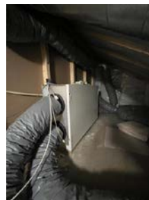
Balansert anlegg plassert på kryploft
