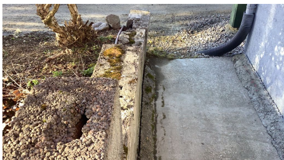
Skjevhet i forstøtningsmur.
