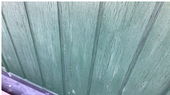
Værslitt treverk på balkongdør.
