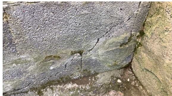
Sprekkdannelse i forstøtningsmur.
