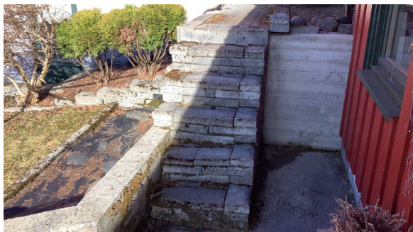
Rekkverk mangler på trapp.
