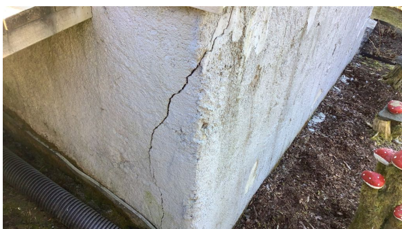
Skråriss i murvegg.
