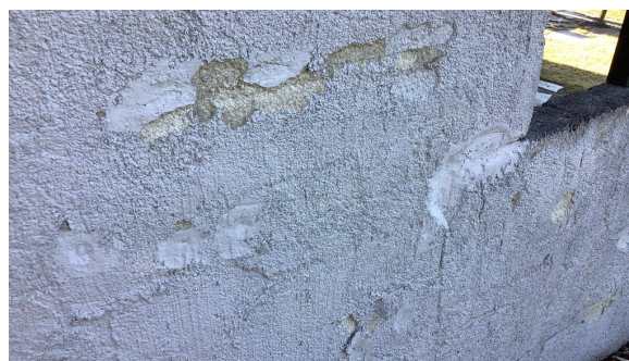
Manglende puss på murvegg.
