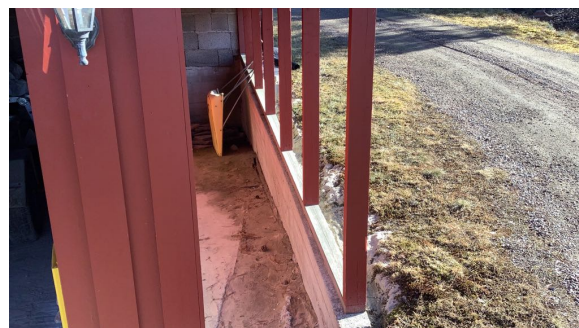
Manglende rekkverk på forstøtningsmur.
