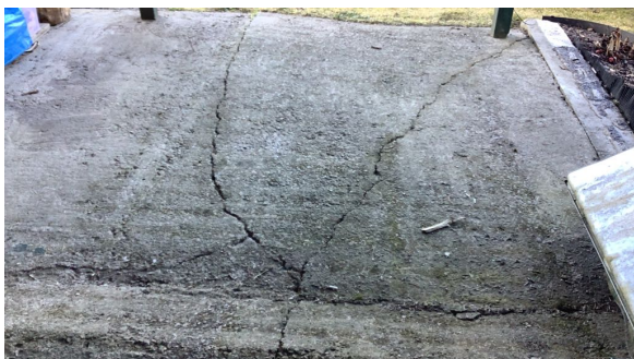
Sprekker i betonggulv.
