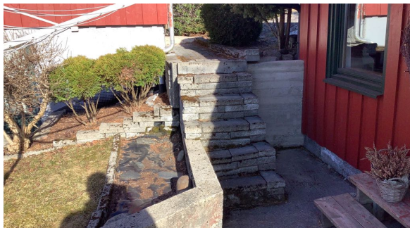
Manglende rekkverk på forstøtningsmur.
