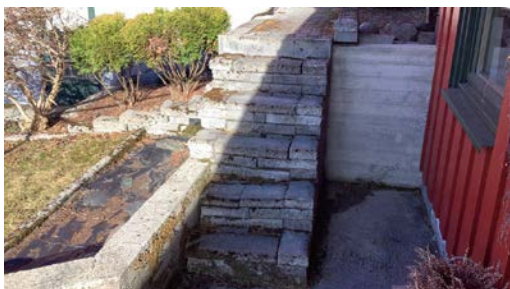
Rekkverk mangler på trapp.
