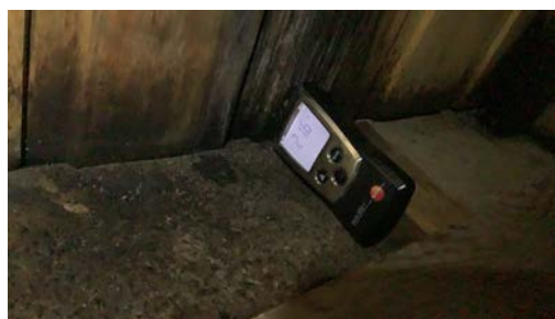
Skadelig fuktinnhold i misfarget panel på bodrom.
