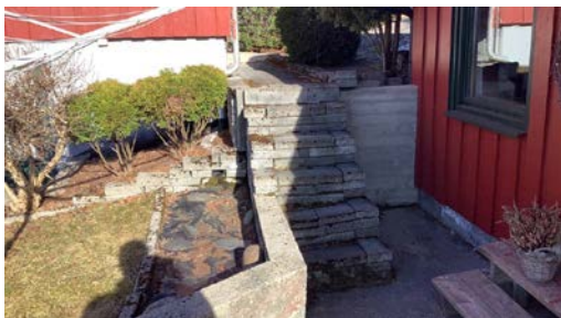
Manglende rekkverk på forstøtningsmur.
