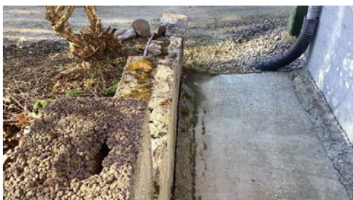
Skjevhet i forstøtningsmur.
