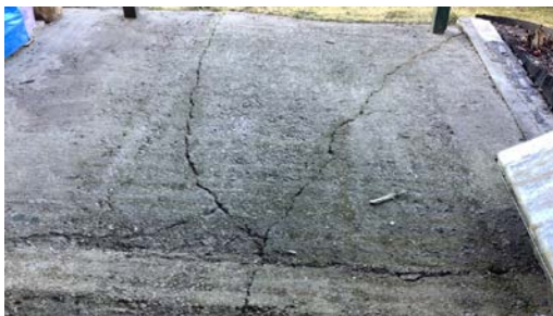
Sprekker i betonggulv.
