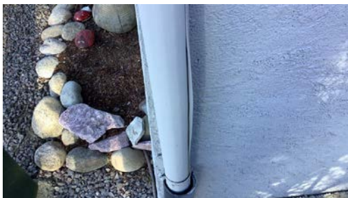
Eksempel på frostsprengt nedløpsrør.
