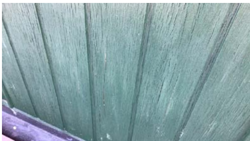
Værslitt treverk på balkongdør.
