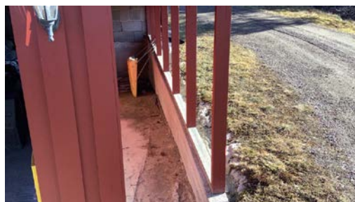
Manglende rekkverk på forstøtningsmur.
