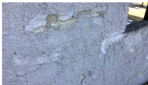
Manglende puss på murvegg.
