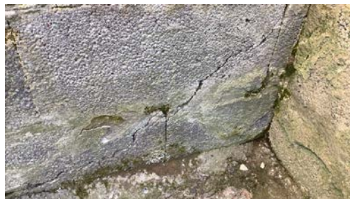
Sprekkdannelse i forstøtningsmur.
