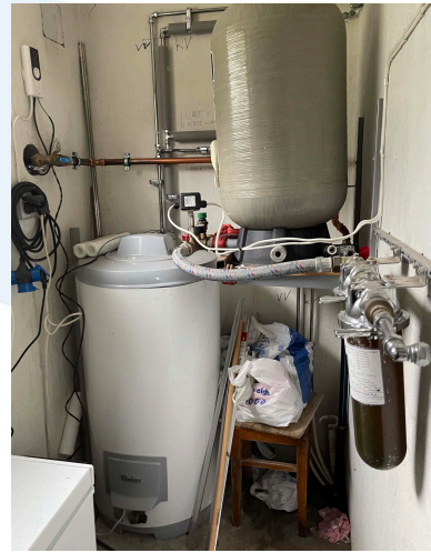
Teknisk rom i underetasje
