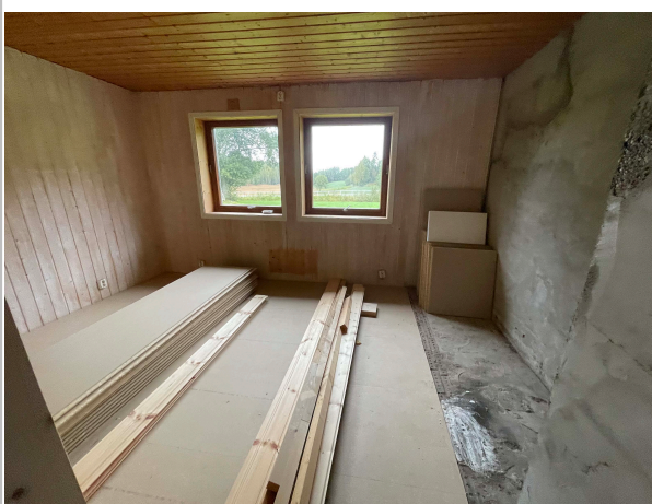
Uferdige rom i underetasje
