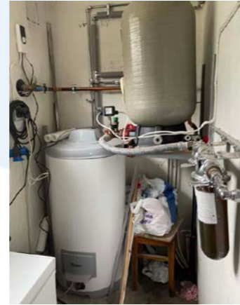
Teknisk rom i underetasje
