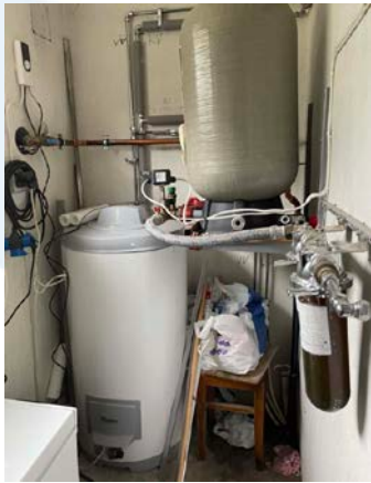
Teknisk rom i underetasje
