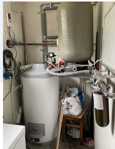
Teknisk rom i underetasje
