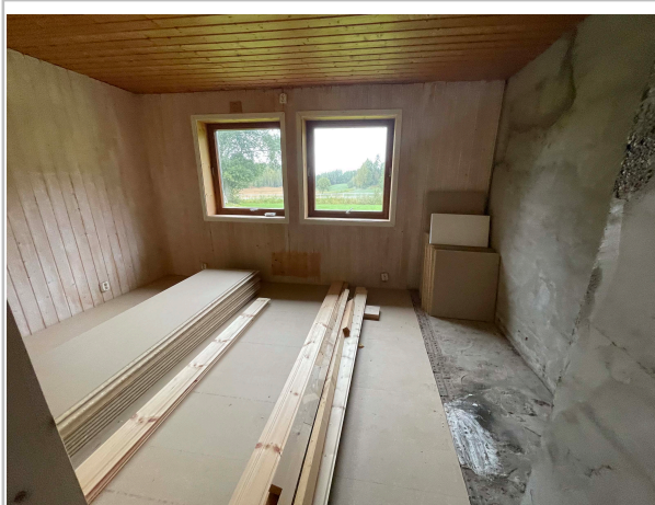
Uferdige rom i underetasje
