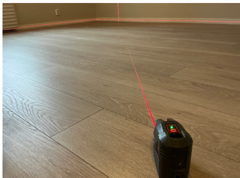
Nivellering soverom, avvik
