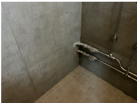
Eldre rør, usikre gjennomføringer
