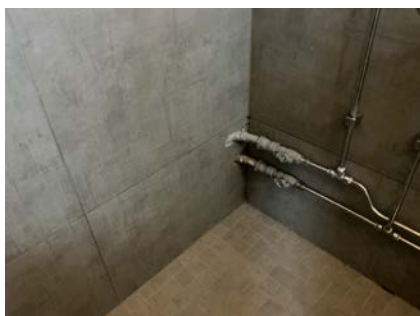
Eldre rør, usikre gjennomføringer
