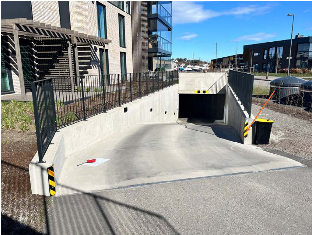
Støttemur som bli påkjørt markert med rød pil. (Foto: Holar Ola Roald AS).
