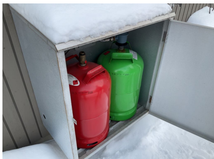
Utvendig skap for propanflasker
