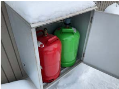
Utvendig skap for propanflasker
