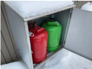
Utvendig skap for propanflasker
