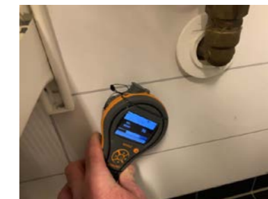
Ved fuktsøk på vegg er det ikke registrert måleverdier som indikerer fukt.
