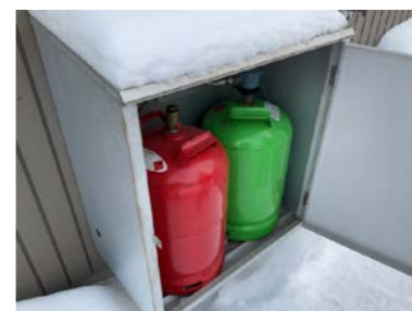
Utvendig skap for propanflasker
