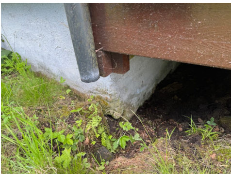
Taknedløp uten kontrollert bortledning.
