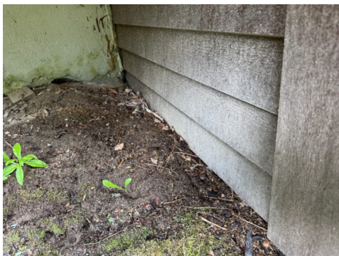
Liten del av veggkledning under terrasse ligger under terreng.
