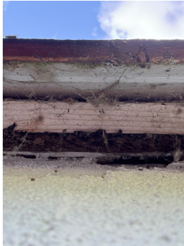
Ingen påvist lufting bak kledning.
