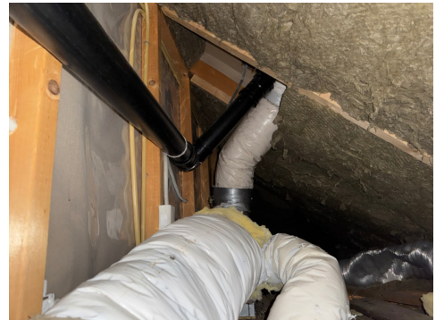
Ingen isolasjon rundt rørgjennomføring i tak.
