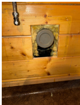
Stakeluke bak luke i vegg på vaskerom
