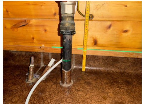
Oppstikk vannrør i plast
