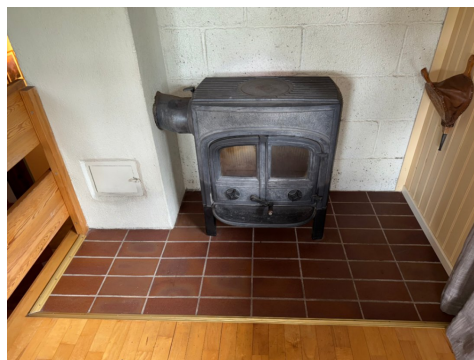
Sotluke nær rekkverk.
