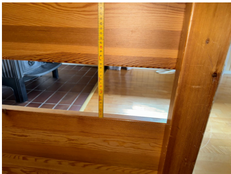
Åpninger i rekkverk 15,5 cm.
