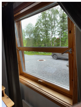
Begrenset funksjon på åpning av vindu
