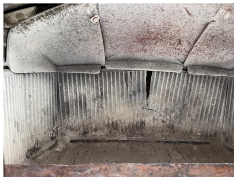
Sprekk i brannkammer
