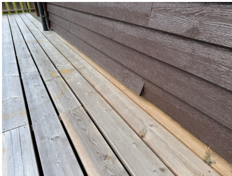
Stedvis tørr og vridd kledning
