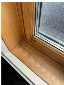
Fuktmerker etter kondensering
