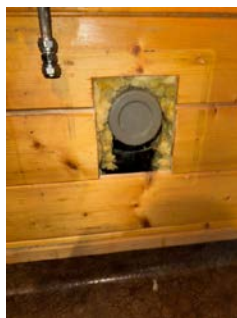
Stakeluke bak luke i vegg på vaskerom
