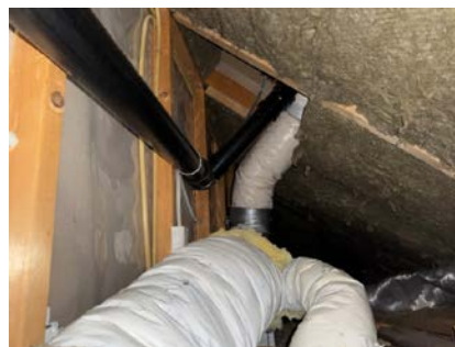
Ingen isolasjon rundt rørgjennomføring i tak.
