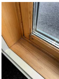
Fuktmerker etter kondensering
