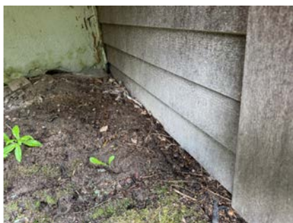
Liten del av veggkledning under terrasse ligger under terreng.
