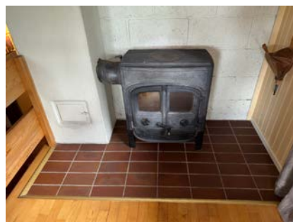
Sotluke nær rekkverk.
