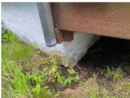
Taknedløp uten kontrollert bortledning.
