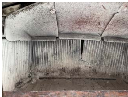
Sprekk i brannkammer
