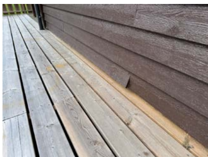
Stedvis tørr og vridd kledning
