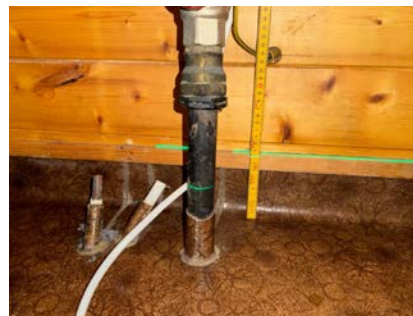
Oppstikk vannrør i plast
