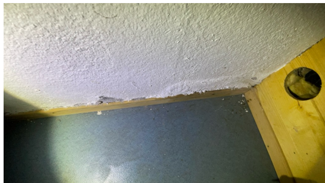
Kalkutslag på grunnmur i underetasje.
