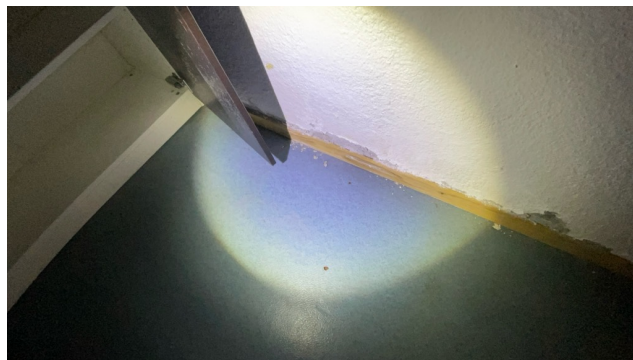
Kalkutslag på grunnmur i underetasje.
