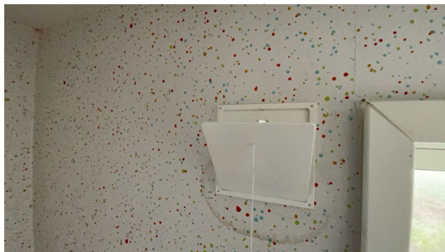
Merker etter tidligere fukt i tapet rundt ventil i soverom.
