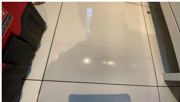
Sprekker i gulvfliser i entre/gang.
