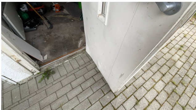
Dør til bod under terrasse har betydelige fuktskader.
