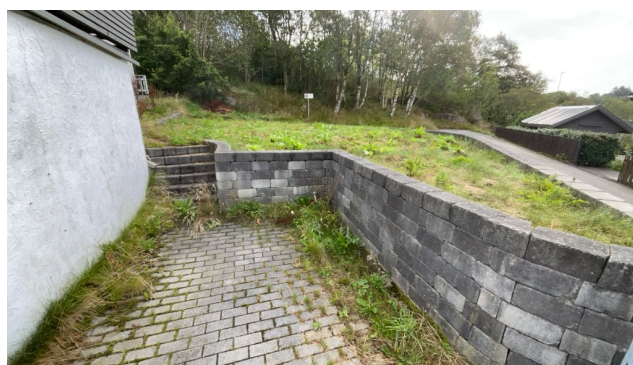
Støttemur i hage mangler rekkverk.
