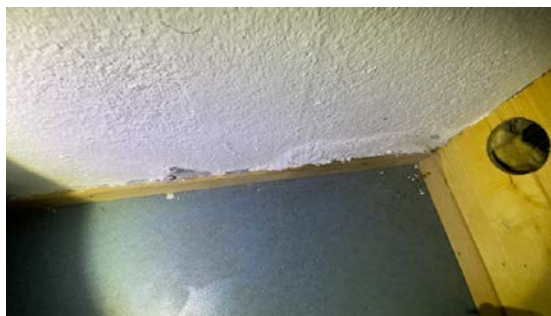
Kalkutslag på grunnmur i underetasje.
