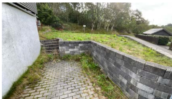
Støttemur i hage mangler rekkverk.
