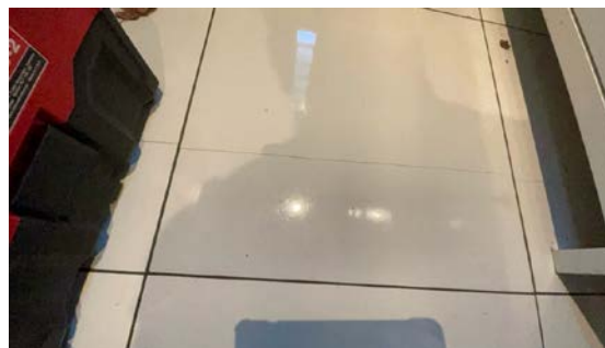
Sprekker i gulvfliser i entre/gang.
