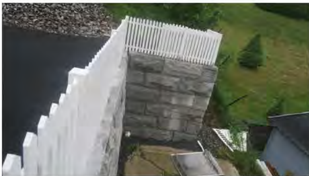
3 meter høy støttemur av granittblokker. Dokumentasjon på bakenforliggende masser og oppbygning er ikke fremlagt for meg. Det bør dokumenteres at mur og bakenforliggende masser er utført fagmessig.
