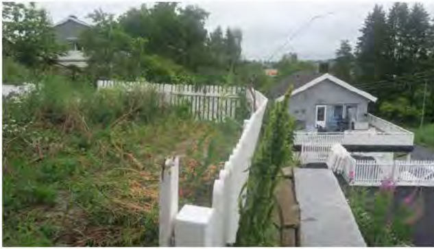
Mur og gjerde fra 2016 heller voldsomt ut og må være i bevegelse. Eier opplyser at dette er blitt gradvis mye verre generelt for eiendommen.
