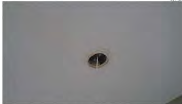
Fuktmerker i himling fra innfelt belysning.
