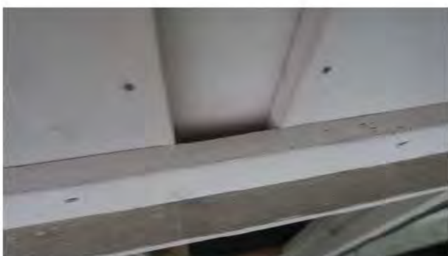
Belistning er lagt utenpå overligger med åpning for vann bak belsitning.
