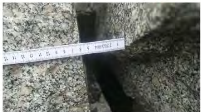
Det er 6 cm glippe i toppen. Det er ikke kjent hvordan dette har sett ut når dette var nytt.
