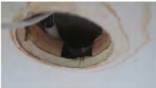
Dampspærre er kappet og varm, fuktig luft vil komme opp i konstruksjoner og medføre kondensskader slik vi ser har skjedd her, når varm fuktig luft kjøles ned på kald side av isoleringen i kalde årstider.
