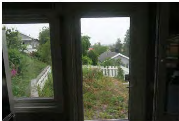
Det er ikke kjent hvordan vinduer og dører er montert.
