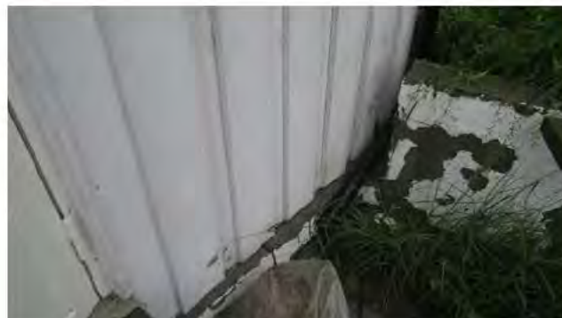
Takvann ledes rett ned ved tilbygg. Det er høy fuktbelastning ved og under tilbygg som øker risikoen for fuktskader.
