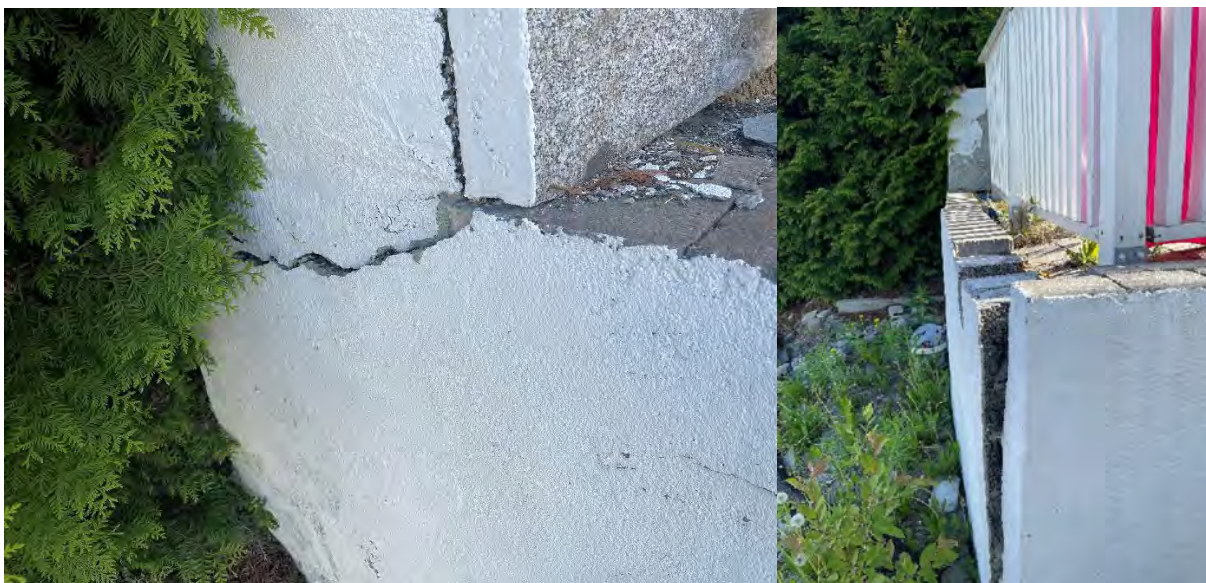
Figur 15: Observert oppsprekking og deformasjon. Til venstre: Støttemur i topp holdes igjen pga. lengde inn i terrenget, støttemur i bunn presses ut i bunn. Til høyre: Betydelig deformasjon og oppsprekking, størst deformasjon sentralt i støttemuren, mellom trappegang og nabotomt. Masser bak støttemuren synker inn.
