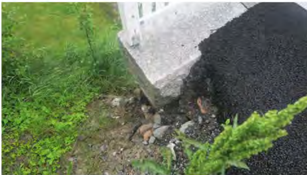
Massene som er synlige er synes å ikke være drenerende. Masser bak muren er ikke kjent.
