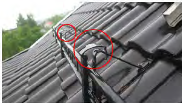
Alle klipsene på snøfangerne er feilmontert og snøfangerne kan falle av ved et hvilket som helst snøfall. Klispen kan når som helst hoppe av.
