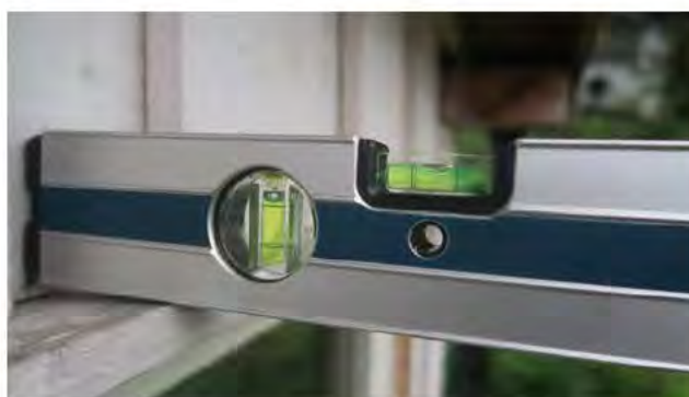
Motfall på vannbrett gjør at vann ledes inn mot veggen o stedet for vekk fra veggen.
