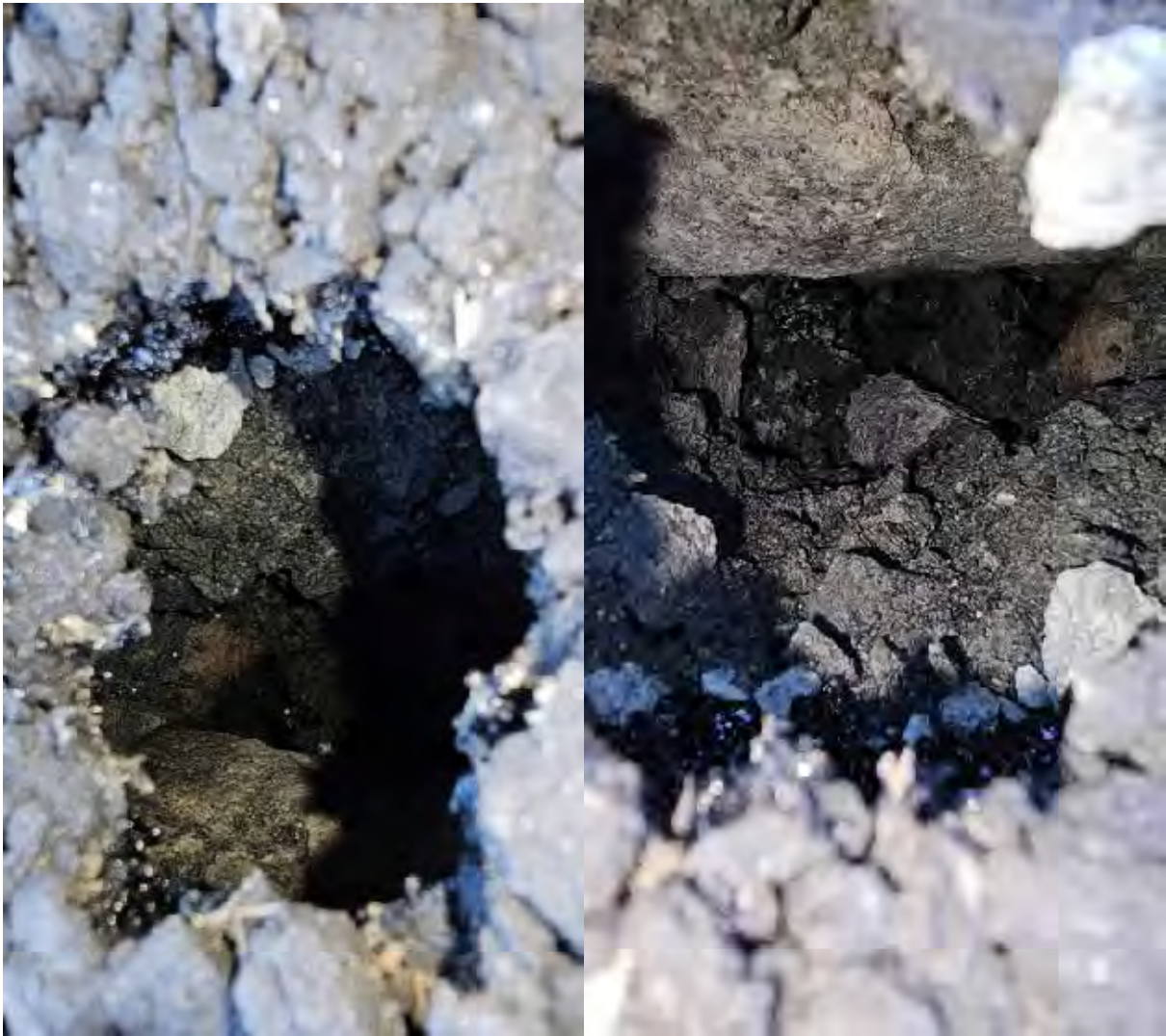
Figur 5: Hull/hulrom i asfalten like ved støttemur ned mot Skoleveien. Bilde oversendt av boligeier, [REDACTED].
