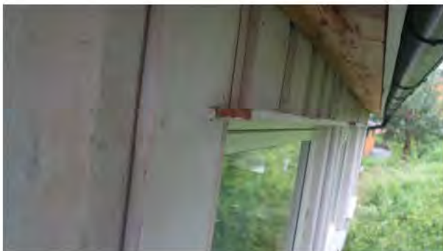
Også langs langvegg er dette feil montert.
