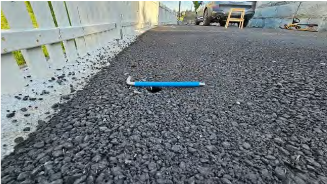
Figur 6: Hull i asfalten inn mot støttemur ved Skoleveien. Bilde oversendt av boligeier, [REDACTED].
