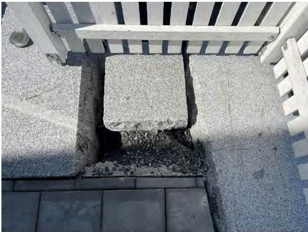
Figur 11: Bildet til høyre: Tydelige deformasjoner i grunnen, granittblokker i overgang mellom støttemur og trapp.
