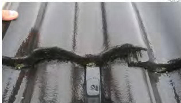
Taksteinene "rir" på både stigetrinn og konsoller for snøfangere. Monteringsveiledning er ikke fulgt og faren for brekkasje er stor.
