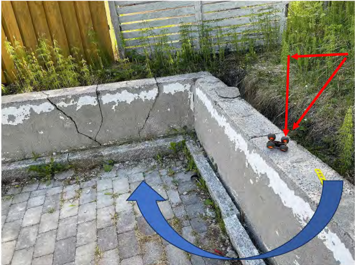
Figur 16: Oppsprekking kan tyde på horisontale og vertikale spenninger på støttemur til høyre i bildet, som igjen fører til at masser og støttemur presses opp 1-1,5 meter fra skråningen.
