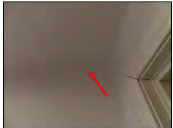
Sprekker i overgang mellom vegg og tak.
