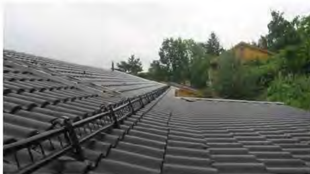
Snøfangere er montert på taket.
