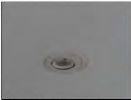
Fuktskjolder rundt downlights
