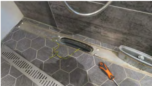
Sluk i bad underetasje.
