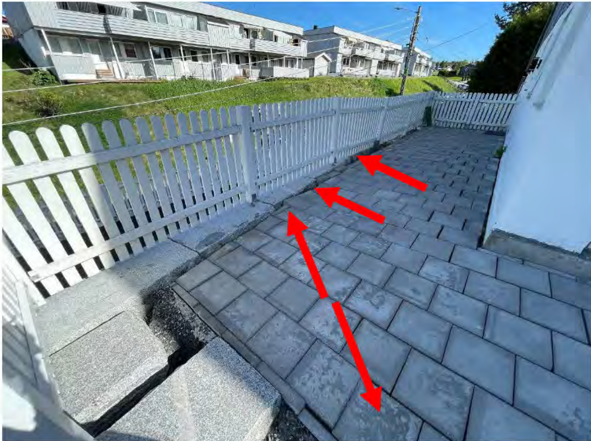
Figur 10: Topp mur like ved bolig. Deformasjon i overgang trapp/støttemur observeres i granittblokker til venstre i bildet. Fall illustreres med røde piler og gir en indikasjon på kreftenes retning. Det er betydelig visuell utvikling fra året før, større sprekker mellom steinhellene, nærmere inn mot boligen enn året før.
