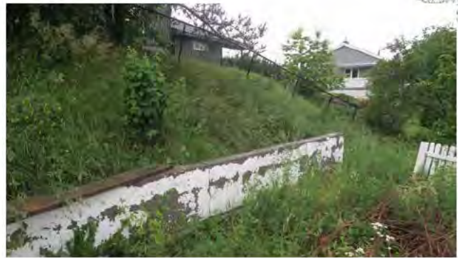
Mur fra 2016/2017 er i dårlig forfatning.
