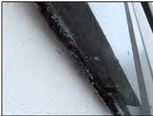
På dette bilde ser vi at puss ikke hindrer luftingen
