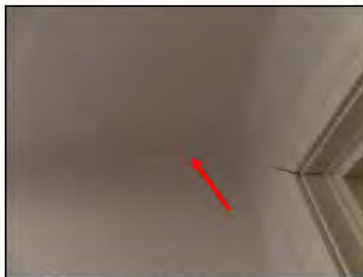
Sprekker i overgang mellom vegg og tak.
