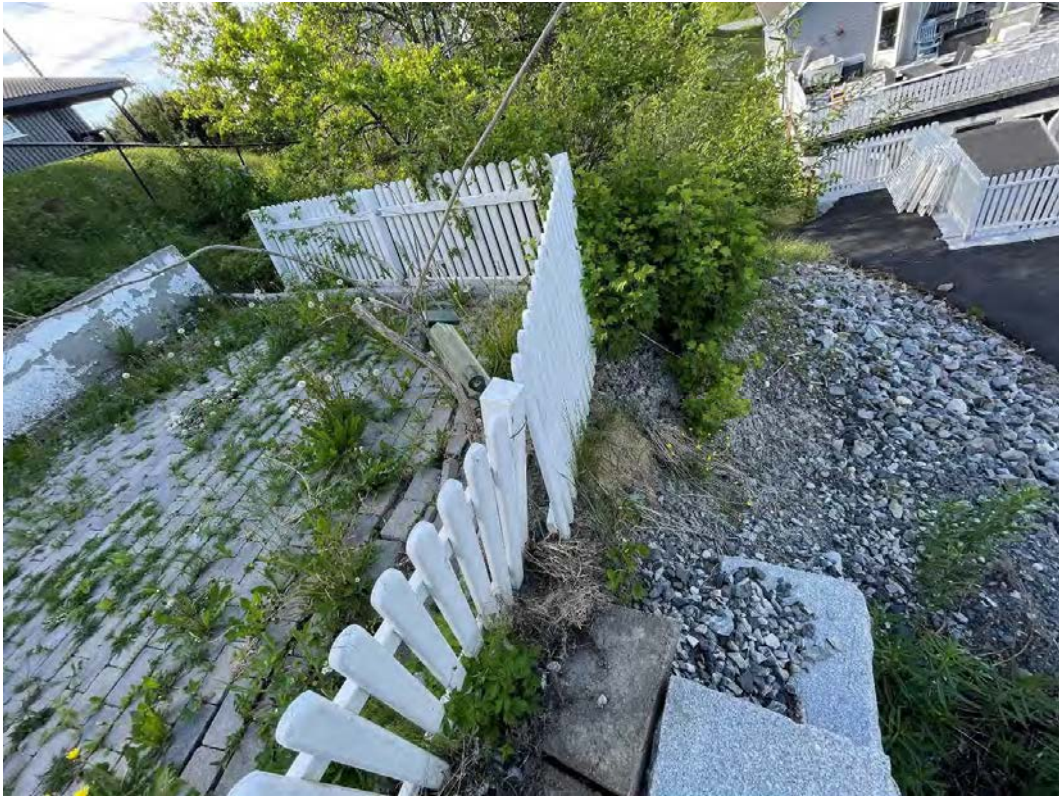
Figur 13: Innsynkning av terreng mot nord (der det ikke er støttemur) tyder også på at massene i disse skråningene er i bevegelse.
