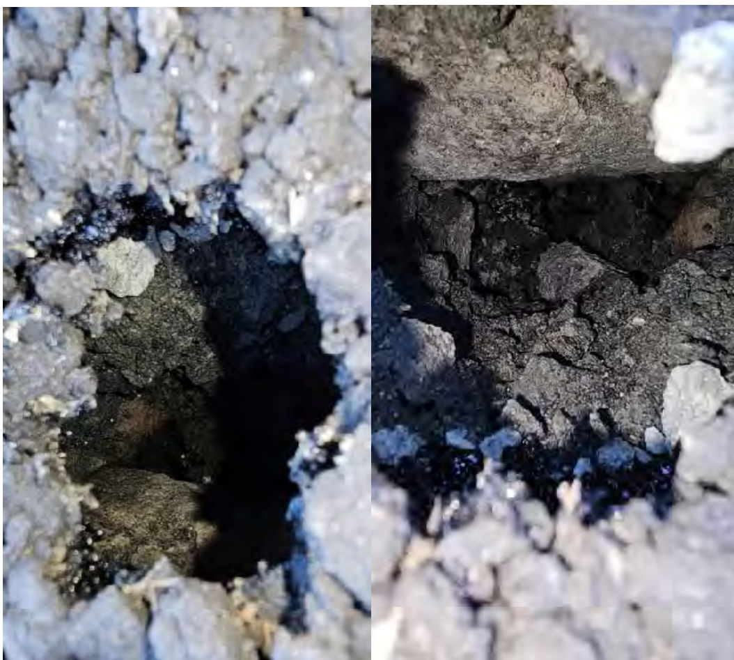
Figur 5: Hull/hulrom i asfalten like ved støttemur ned mot Skoleveien. Bilde oversendt av boligeier, [REDACTED].
