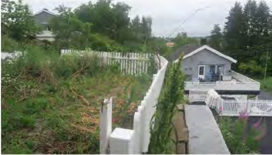
Mur og gjerde fra 2016 heller voldsomt ut og må være i bevegelse. Eier opplyser at dette er blitt gradvis mye verre generelt for eiendommen.
