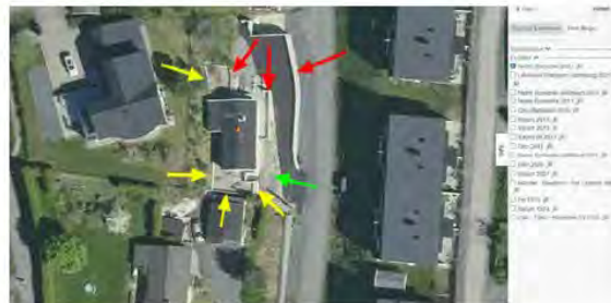
Bilde hentet fra Norge i bilder fra 2021 viser ferdig asfaltert oppkjøring, ferdige støttemurer av lettklinkerblokker og stablemurer. Rød pil=Granittmur stablet, grønn pil=sprengsteinsmur, gul pil=mur av lettklinkerblokker
