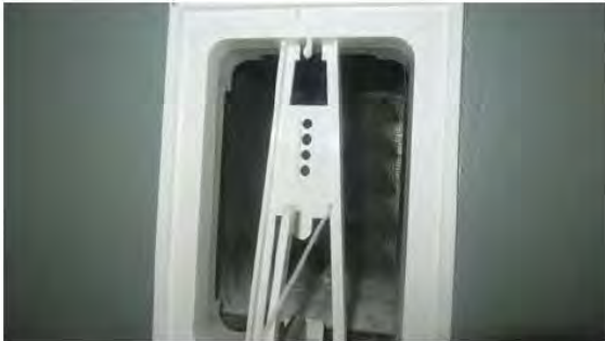
Ventilen skulle vært blendet før ny yttervegg på tilbygg ble oppført og ny ventil skulle vært montert. .
