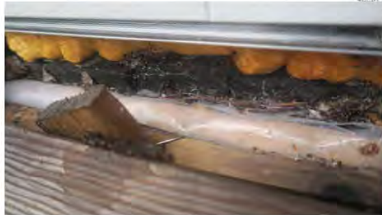
Det er ikke fagmessig forseglet under terrassedør. Skum holder på å forvitre og vann trenger lett inn.
