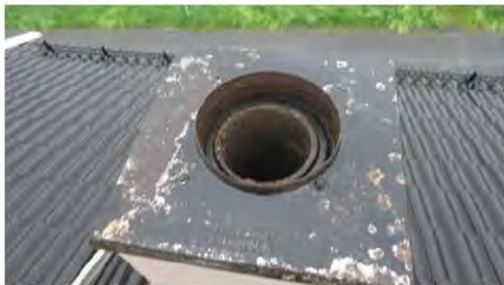
Pipe sett fra yttertak.
