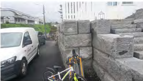
Muren virker å være på vei ut. Langtidsmålinger skal gjennomføres. Det er store glipper og muren heller utover.
