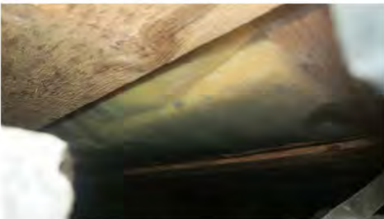
Også her er plasten lagt på kald side og er utsatt for perforering og det er lett for gnagere å komme inn. Eventuell fukt blir sperret inne i konstruksjonen.
