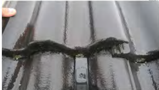
Taksteinene "rit" på både stigetrinn og konsoller for snøfangere. Monteringsveiledning er ikke fulgt og faren for brekkasje er stor.
