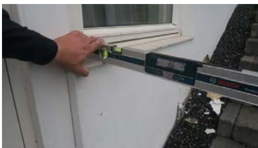
Vannbrett har på dette vindu et fall på 3,6 grader.
