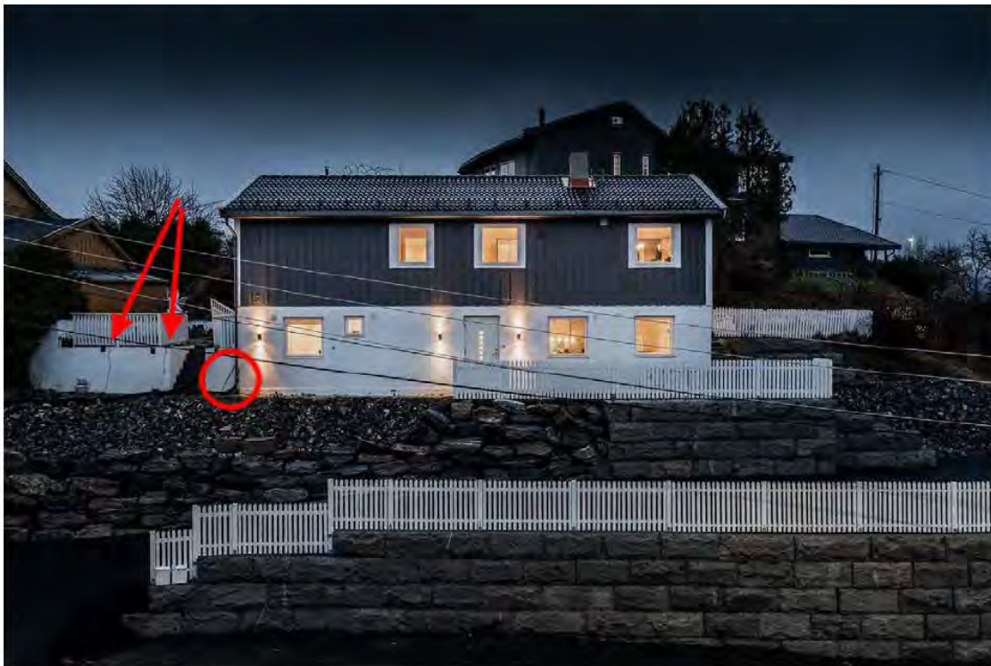
Bilde fra salgsoppgave i 2020. Piler viser større sprekker i støttemurer av lettlinkerblokker. Sprekken er godt synlige. Rød ring viser en buesag og er ikke en sprekke.
