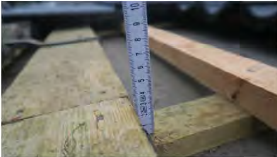
Lenge på festemidler ned i sløyfe er ikke kontrollert.
