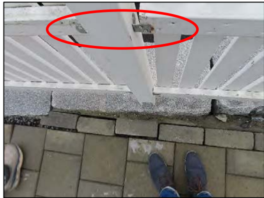
Bilde viser eksempel på svært «spinkel» innfesting av gjerdeseksjon.
