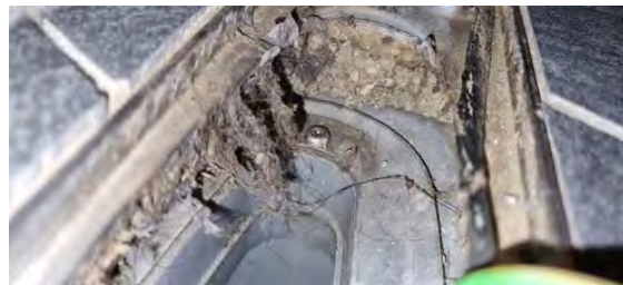
Det er ingen tegn til membran under klemring.
