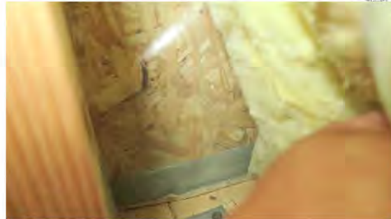
Plast og OSB på innsiden med isolasjon i mellom. Konstruksjonen må bygges om for å bli fagmessig.
