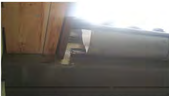
Takrenner er kappet rett av der tilbygg er satt opp. Det er ikke noe endeløkk. Nedbør renner for ut her og medfører stor belastning på konstruksjonene.
