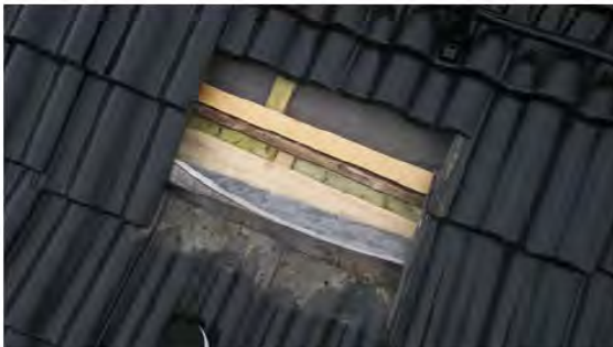
Overgangen er særdeles ufagmessig løst ved at duken er lagt frem til opprinnelig tak med åpenbar lekkasjemulighet i glippen. Alt vann som renner fra hovedtaket under takstein vil ledes rett ned i denne konstruksjonen.
