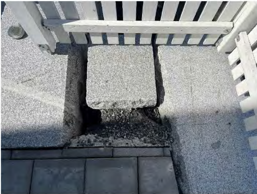
Figur 11: Bildet til høyre: Tydelige deformasjoner i grunnen, granittblokker i overgang mellom støttemur og trapp.
