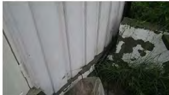
Takvann ledes rett ned ved tilbygg. Det er høy fuktbelastning ved og under tilbygg som øker risikoen for fuktskader.
