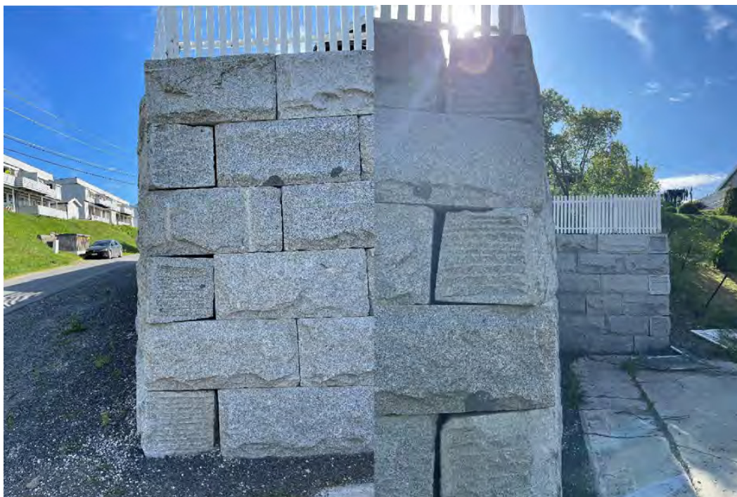
Figur 4: Til venstre ses støttemur i sørlig retning langs Skoleveien. Bildet til høyre er tatt inn mot en liten parkeringsplass i nordøstlig hjørne av tomten. Muren synes å være lite påvirket av deformasjoner i grunnen.
