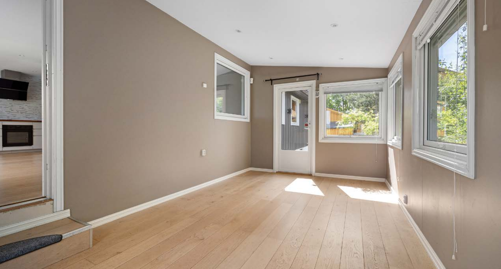
Tilbygget vinterhage utenfor 1. etasje. (Tilbygget er ikke lovlig oppført). Det er konstruksjonsmessige avvik i tilbygget. Interessenter oppfordres til å lese gjennom vedlagte skaderapporter og tilstandsrapport.
