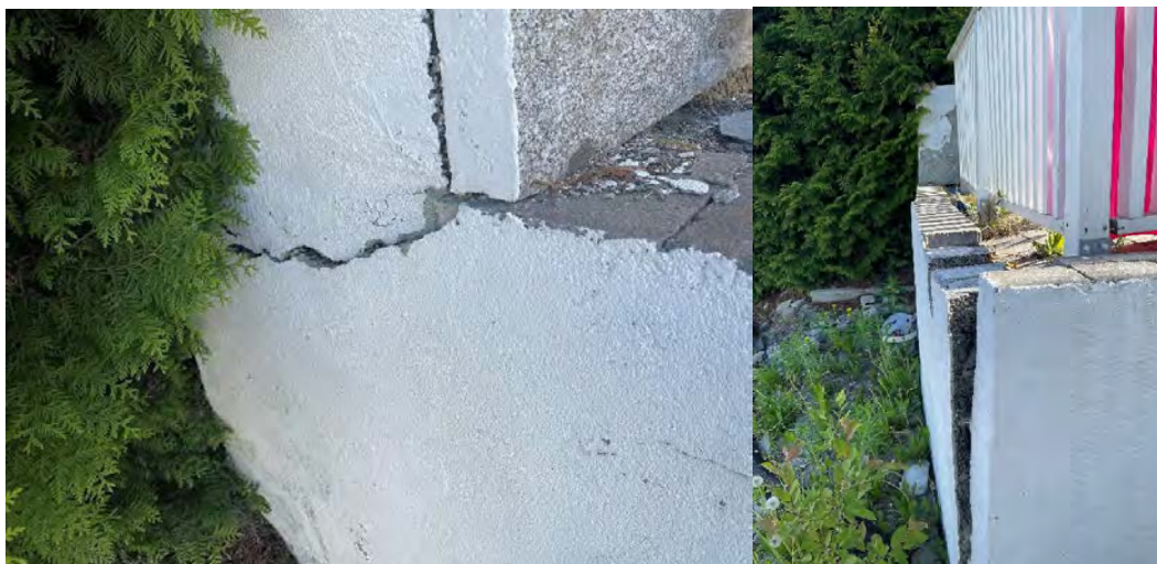
Figur 15: Observert oppsprekking og deformasjon. Til venstre: Støttemur i topp holdes igjen pga. lengde inn i terrenget, støttemur i bunn presses ut i bunn. Til høyre: Betydelig deformasjon og oppsprekking, størst deformasjon sentralt i støttemuren, mellom trappegang og nabotomt. Masser bak støttemuren synker inn.
