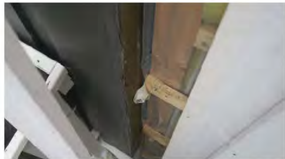
Ufagmessig utførelse. Feil materialbruk og feil utførelse.
