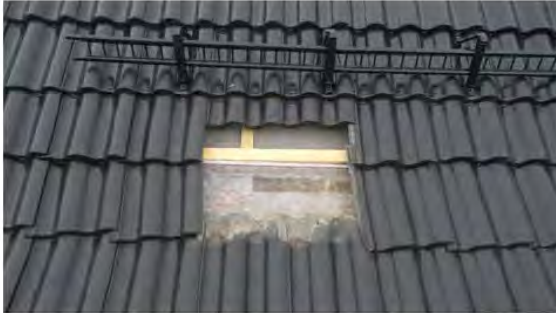
Det ble åpnet ved overgang opprinnelig tak/tak på tilbygg.
