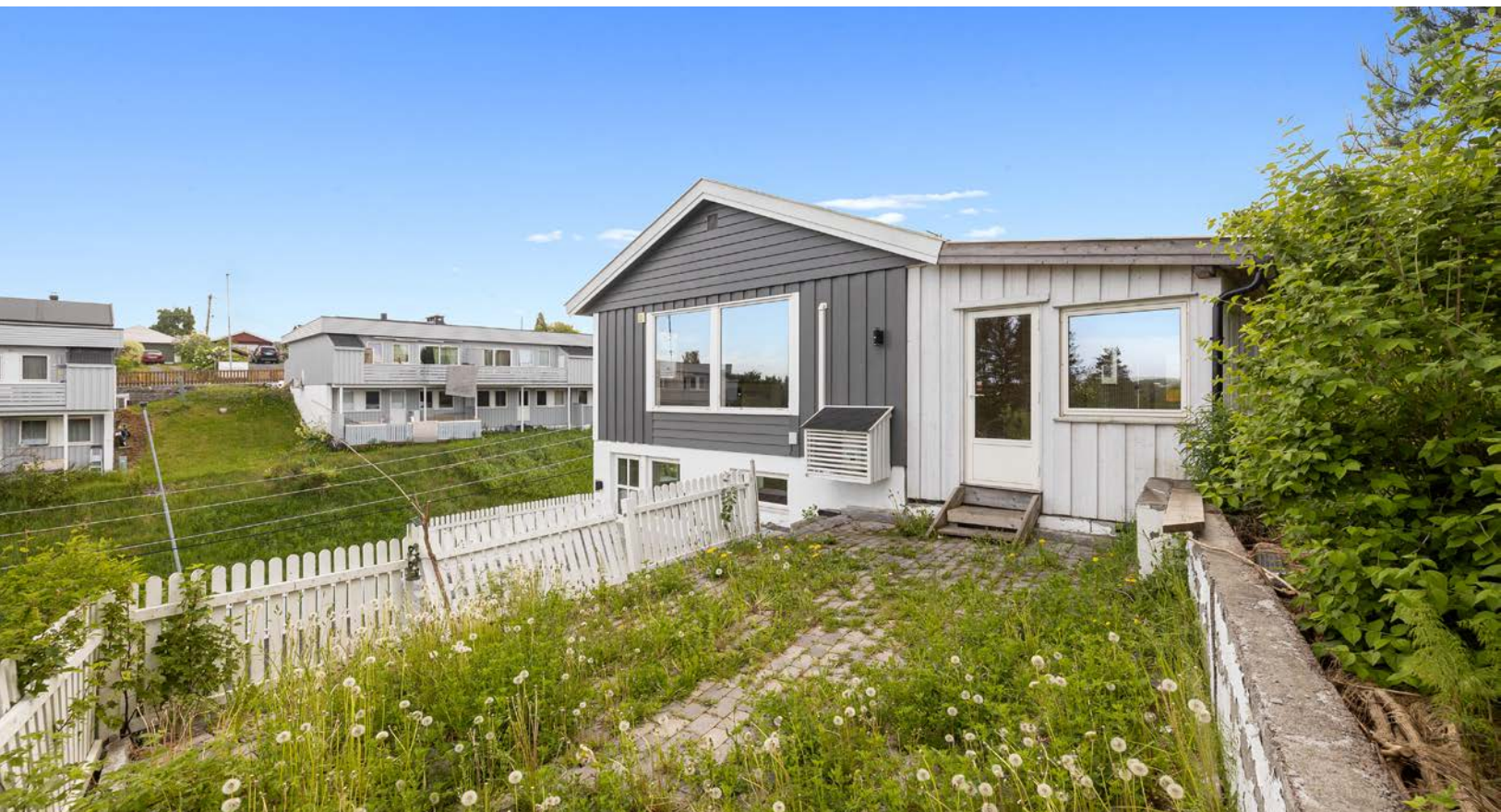
Uteområde. Det er større skader og skjevheter på trapper og murer utvendig. Vennligst se vedlagte skaderapporter.
