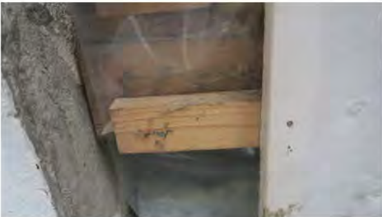
Det er plast på utsiden av yttervegg, og den er ikke forseglet. Feil utførelse på flere områder.
