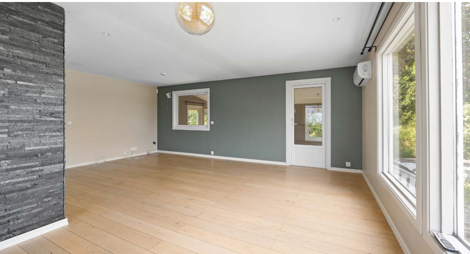
Varmepumpe montert i stuen.
