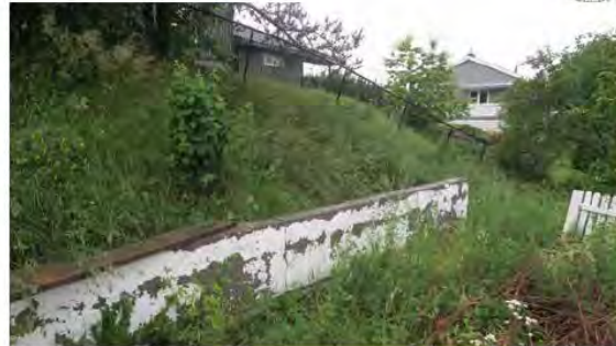
Mur fra 2016/2017 er i dårlig forfatning.
