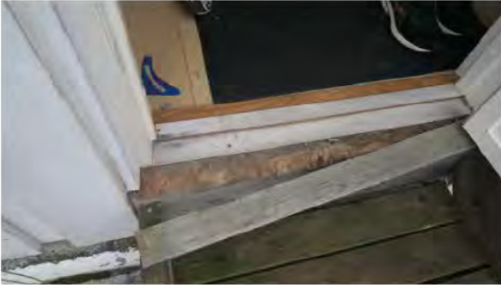
OSB-plate ligger forbi utside av dør. Her kommer vann inn under døra og forårsaker fuktskader og dårlig inneklime over tid.
