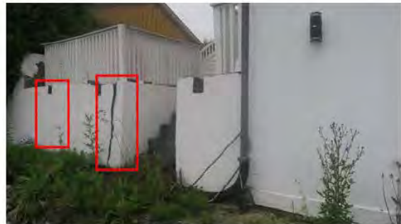
Det er oppstått flere kraftige sprekker i lettklinkermurene.
