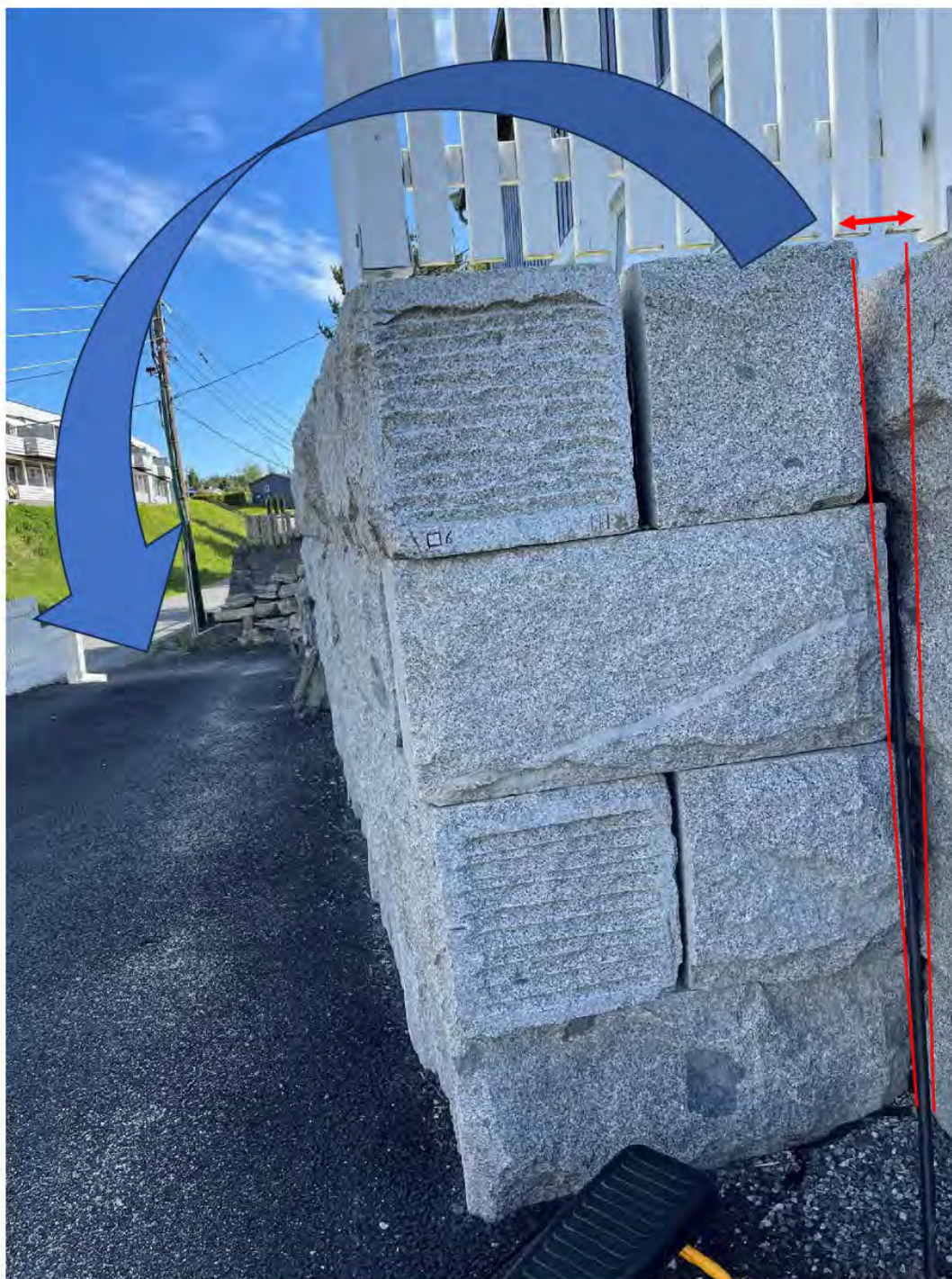
Figur 9: Bilde fra granittmur like nedenfor boligen. Det observeres betydelig forskjell i avstand, fra topp til bunn, inn mot bakenforliggende granitt-trapp.
