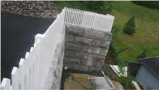
3 meter høy støttemur av granittblokker. Dokumentasjon på bakenforliggende masser og oppbygning er ikke fremlagt for meg. Det bør dokumenteres at mur og bakenforliggende masser er utført fagmessig.
