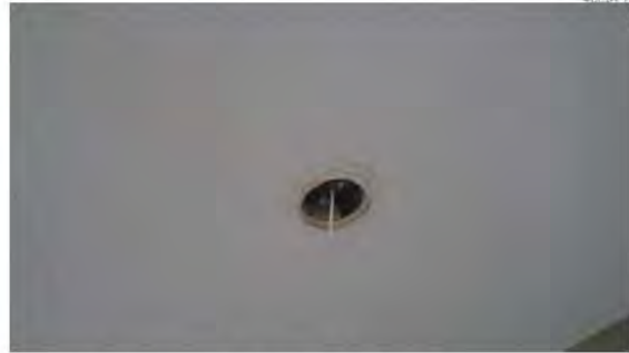
Fuktmerker i himling fra innfelt belysning.
