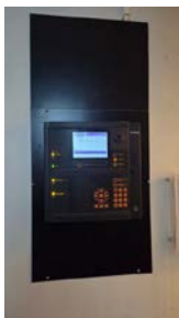
Sentralt brannvarslingsanlegg i bygget
